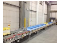
搬送コンベア
