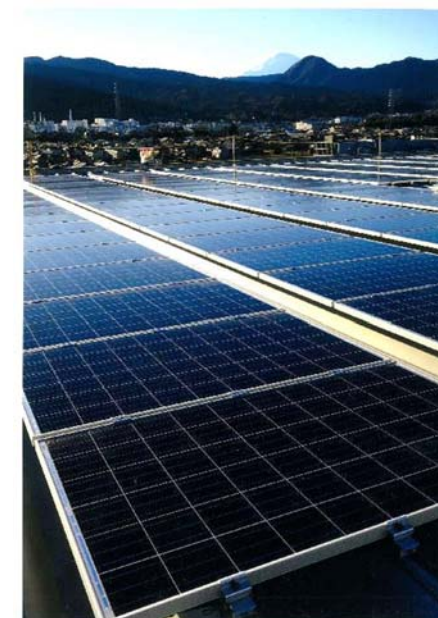
SBSフレイトサービス小田原支店 富士山を望む屋上の太陽光設備
