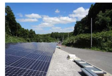
千葉・芝山第2太陽光発電所
