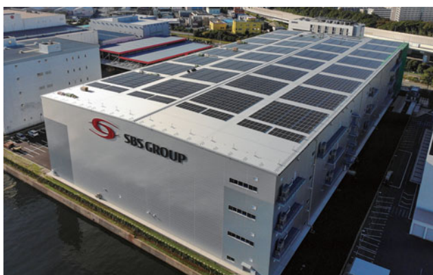
物流倉庫屋上の太陽光発電設備(SBSネクサード 物流センター横浜金沢)
