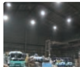
照度が2倍となり、すっかり明るくなった工場内
