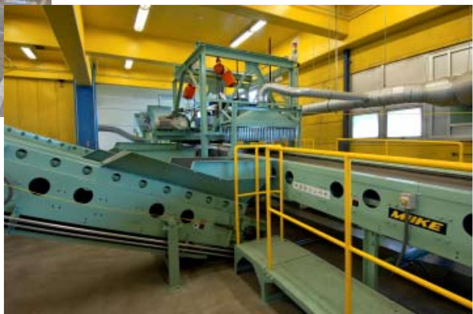
処理設備(ベルトコンベアと選別機)
