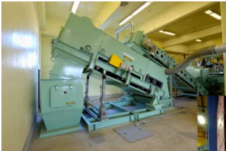
処理設備(破碎機)
