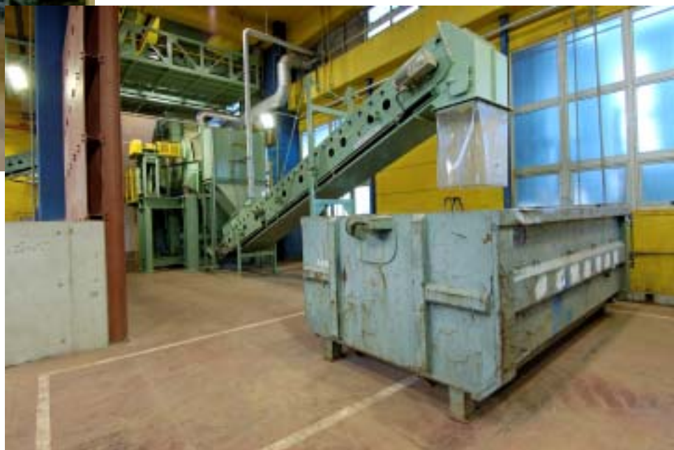
処理設備(破碎物回収カーゴ)
