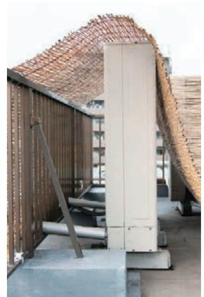
室外機周辺の温度が低いほど、空調機器が効率の良い運転となり、室外機への日射防止によって周囲温度が下がれば、節電につながります。(出典:東京電力)
